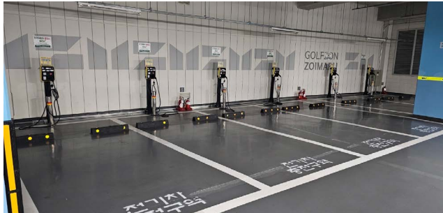
골프존조이마루 전기차 충전소
